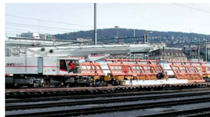
Scarico degli scambi con la gru per la costruzione del binario e dei ponti KRC 1200 T.
